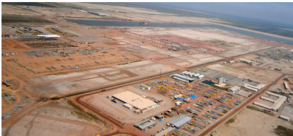
FOTO 28 – ÁREA DO ESTALEIRO OSX, EM CONSTRUÇÃO, JUNTO AO CANAL TX-2, TAMBÉM ATERRADA E DEPOIS TERRAPLANADA, COM AREIA RETIRADA DO CANAL EM CONSTRUÇÃO E TAMBÉM COM SEDIMENTOS DA LAGOA (CANAL) DO VEIGA. NESTA FOTO É POSSÍVEL VER O ESTÁGIO DAS OBRAS DO ESTALEIRO
